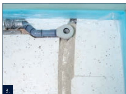
3. Na rohož TE Plus uložit tepelnou izolaci do úrovně instalací. Na stěny po obvodu fixovat okrajový izolační pás, aby nevznikly zvukové mosty.
